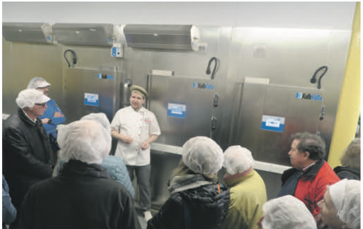
Rolf Weber vor den beeindruckenden, digital gesteuerten Kühlanlagen.
