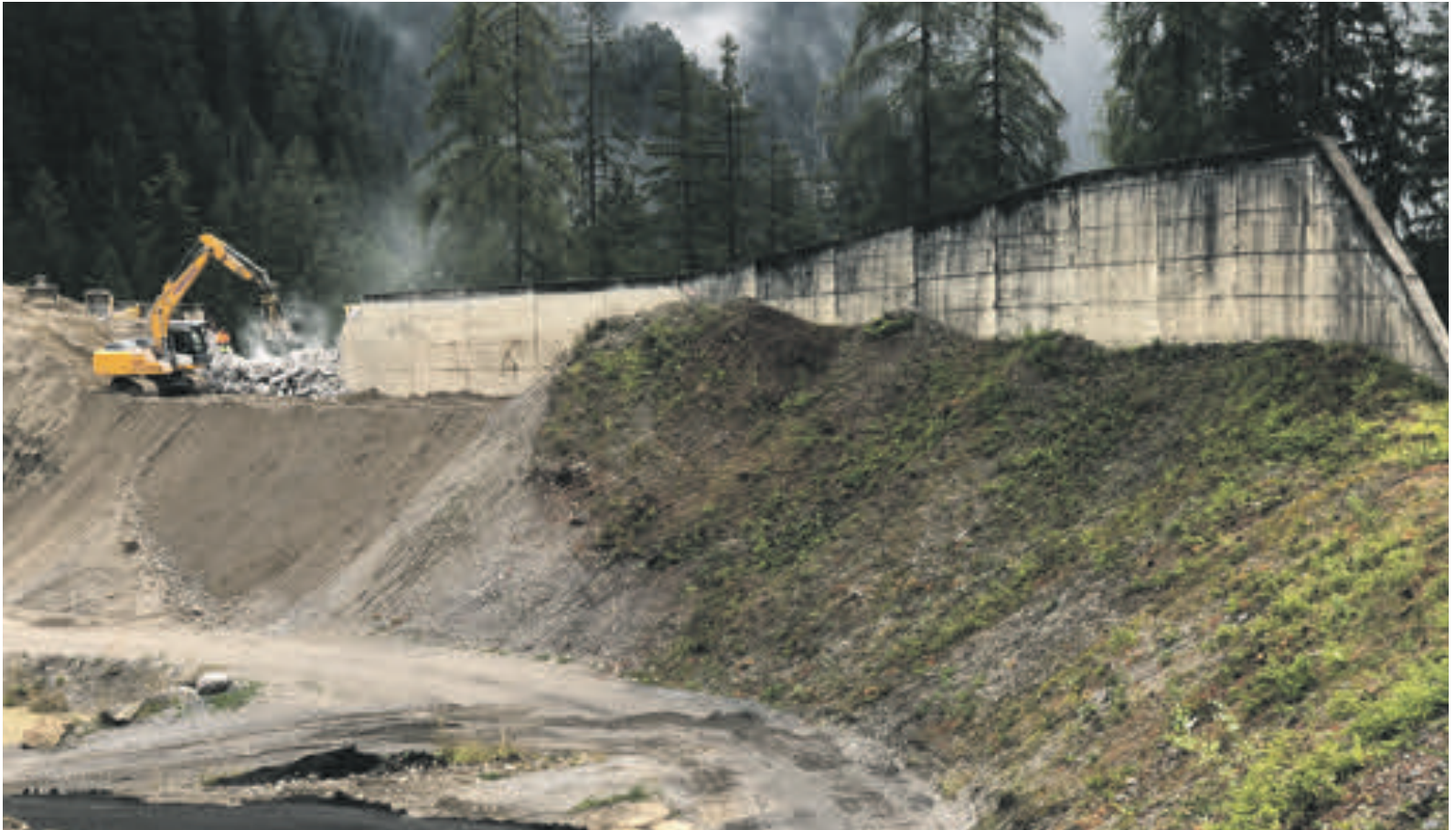
In Davos Wiesen ist in diesen Tagen die neue Kiesgrube geöffnet worden. Die Stützmauer aus den 60er Jahren wurde entfernt.
